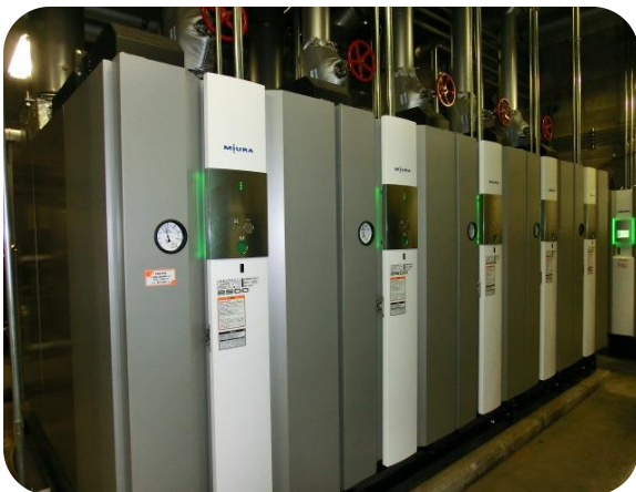
ガスボイラー(本社)
