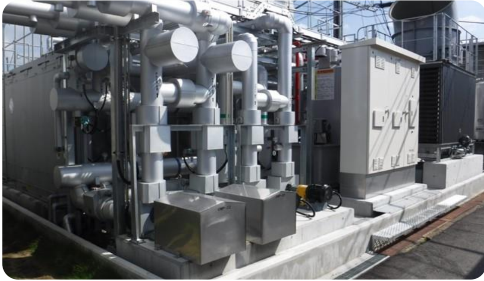
チルド水供給設備
