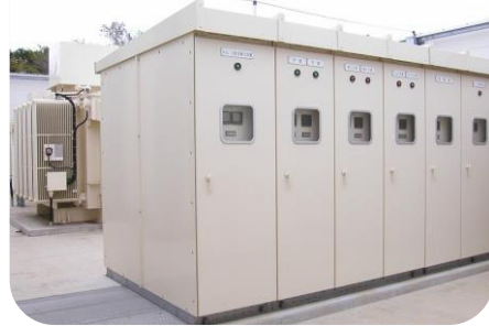
特高受電設備
