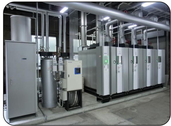
ガスボイラー(長船)
