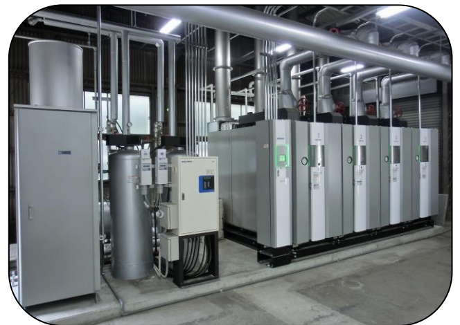
ガスボイラー(長船)
