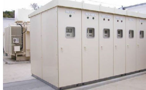
特高受電設備
