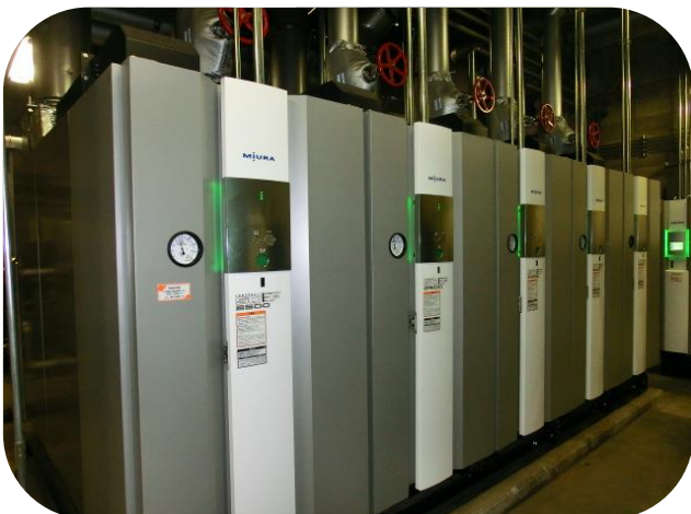
ガスボイラー(本社)
