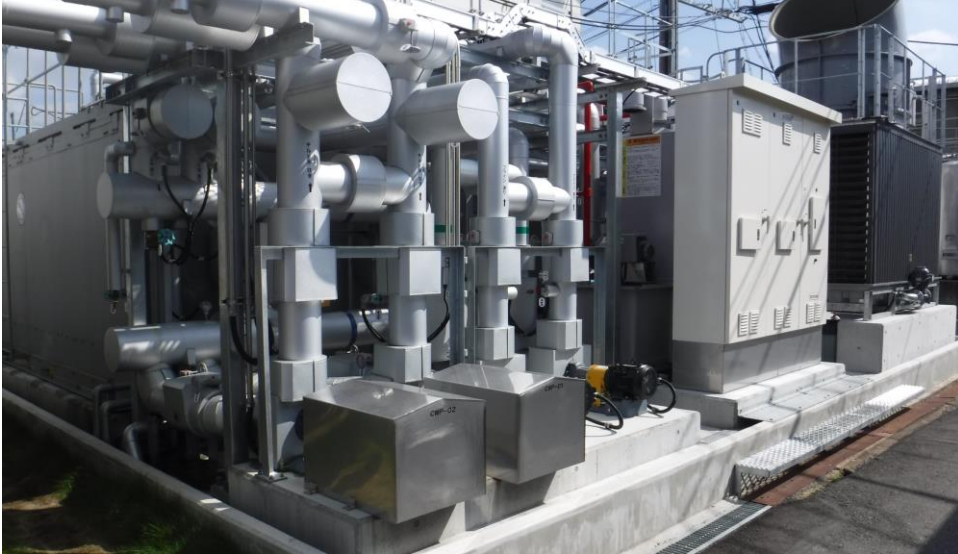
チルド水供給設備
