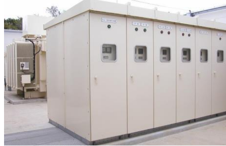
特高受電設備
