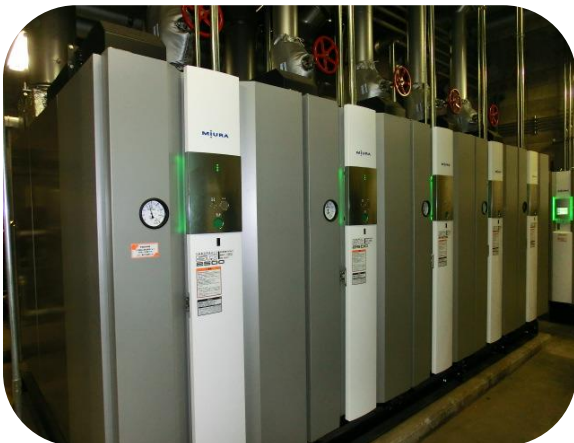
ガスボイラー(本社)
