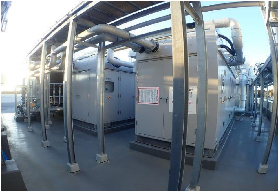
チルド水供給設備
