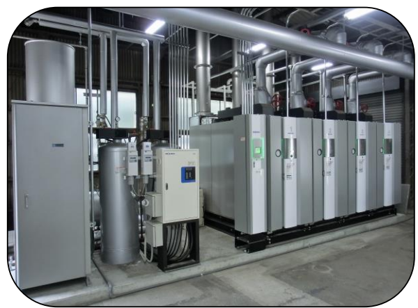
ガスボイラー(長船)
