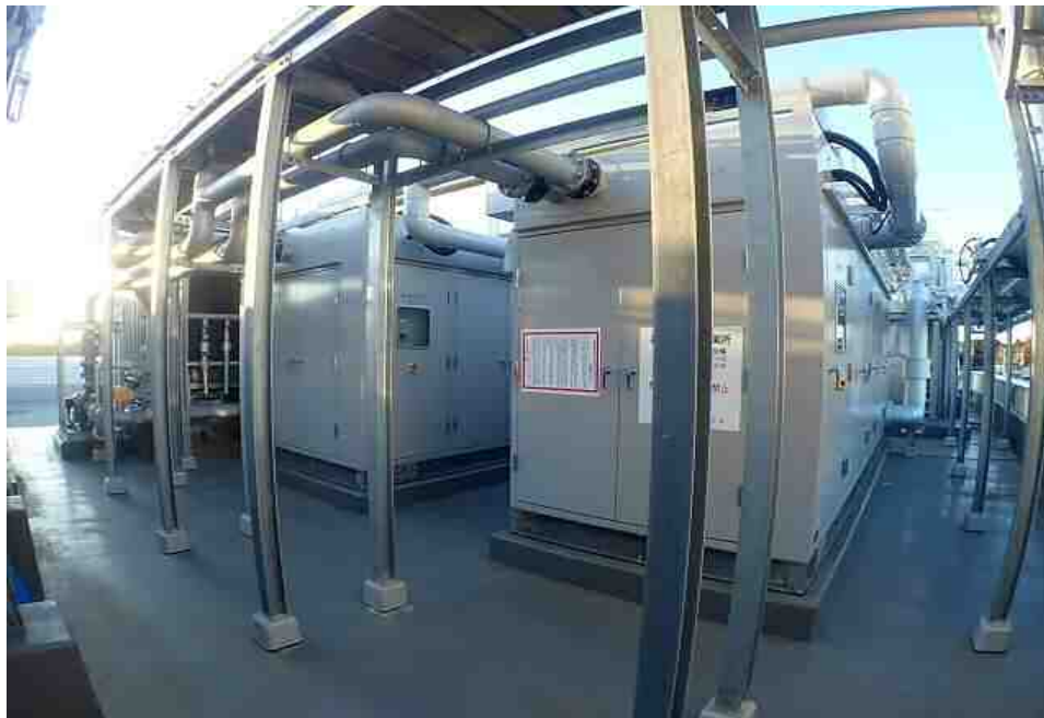
チルド水供給設備
