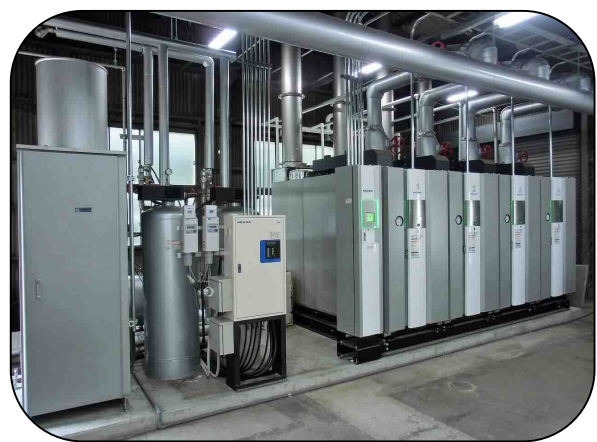
ガスボイラー(長船)
