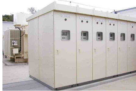
特高受電設備
