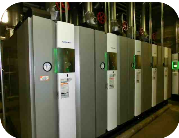
ガスボイラー(本社)
