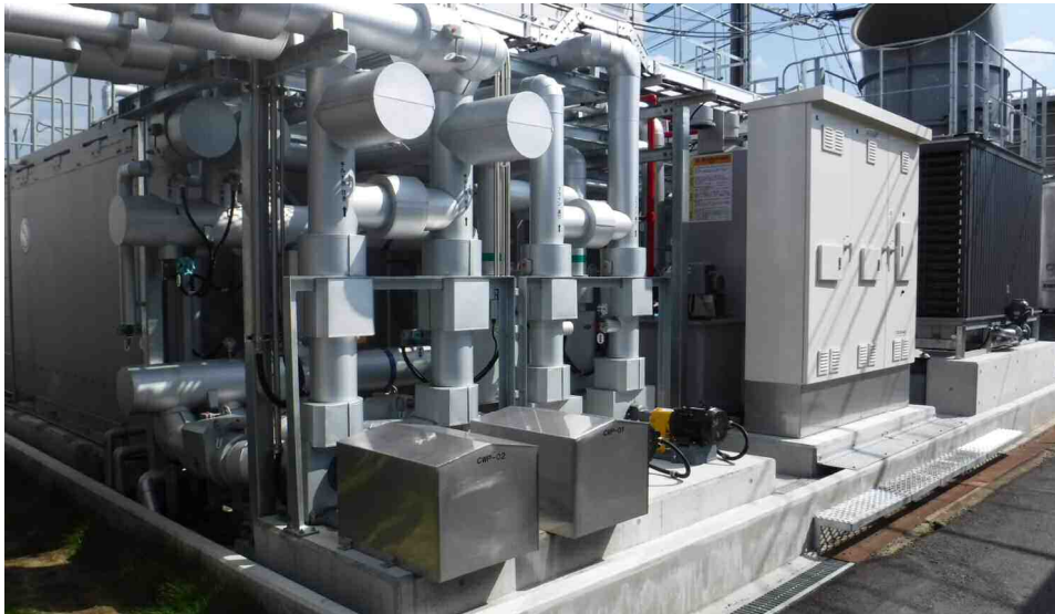
チルド水供給設備
