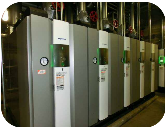
ガスボイラー(本社)
