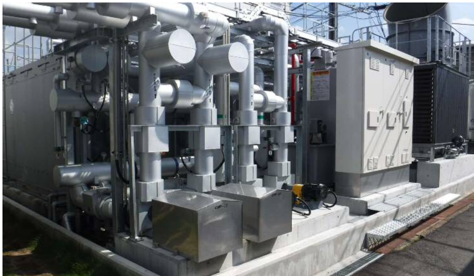
チルド水供給設備
