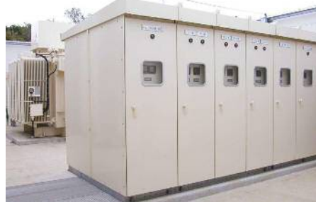
特高受電設備
